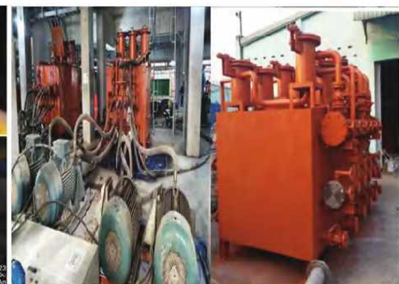
TRẠM NGUỒN SÚC RỬA ĐƯỜNG ỐNG CLEANING & FLUSHING SOURCE STATION
