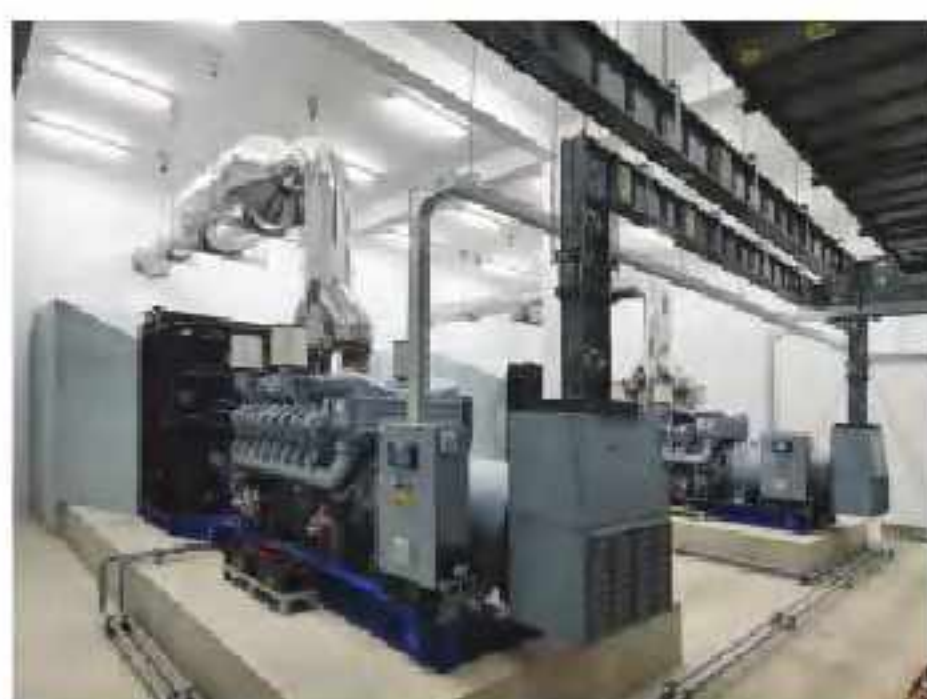
Máy phát điện
