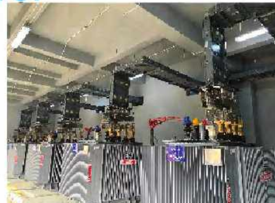
Trạm biến áp - Busway
