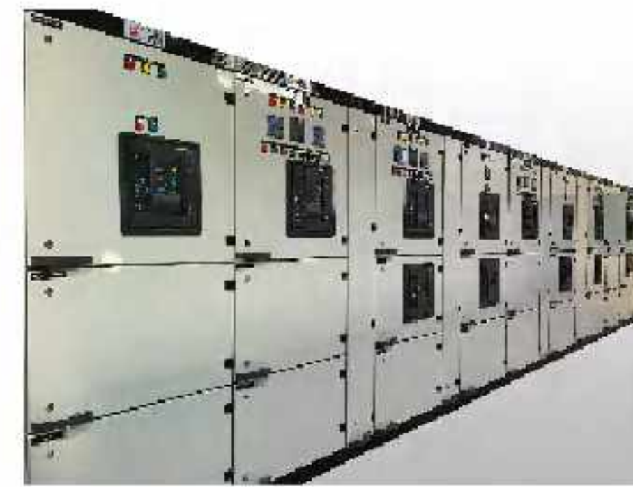
Tủ MSB - Tủ Hoà - ATS
